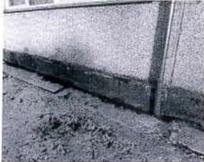
Foto Nr.1. Caurumi zem pamatu aizsargapmales ir aizbūrti ar grunti.
